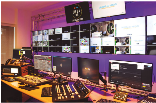
● Sala de control.
